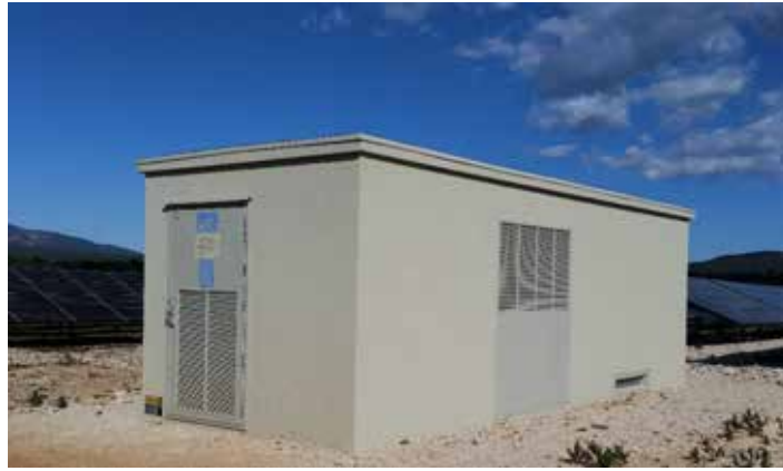
Photo 6 : Exemple de poste de transformation
