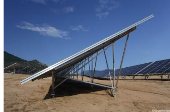
Photo 2 : Structures de support avec modules
