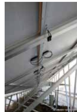
Photo 8 - Câblage sous les modules
